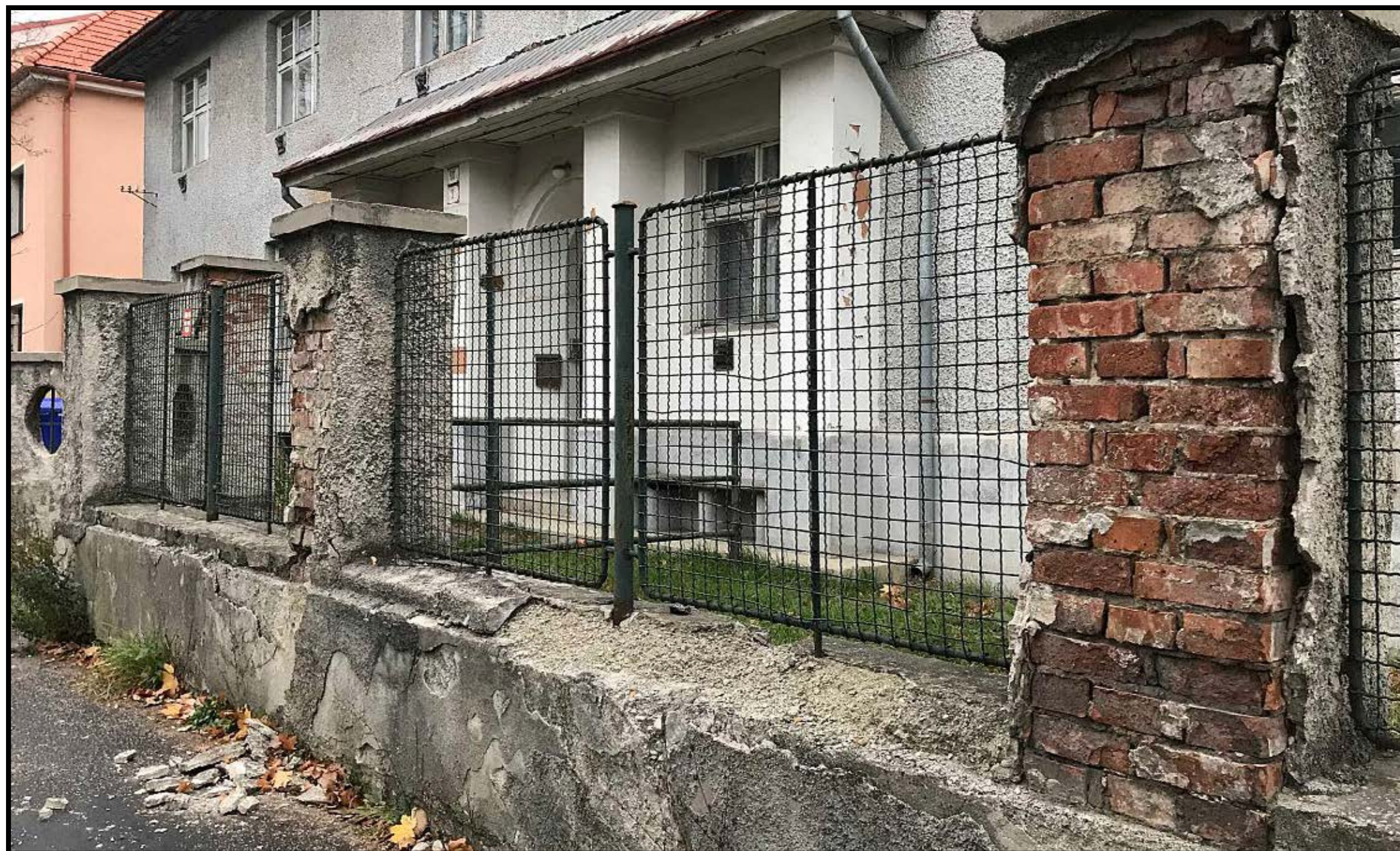
Budova v zlom stave
