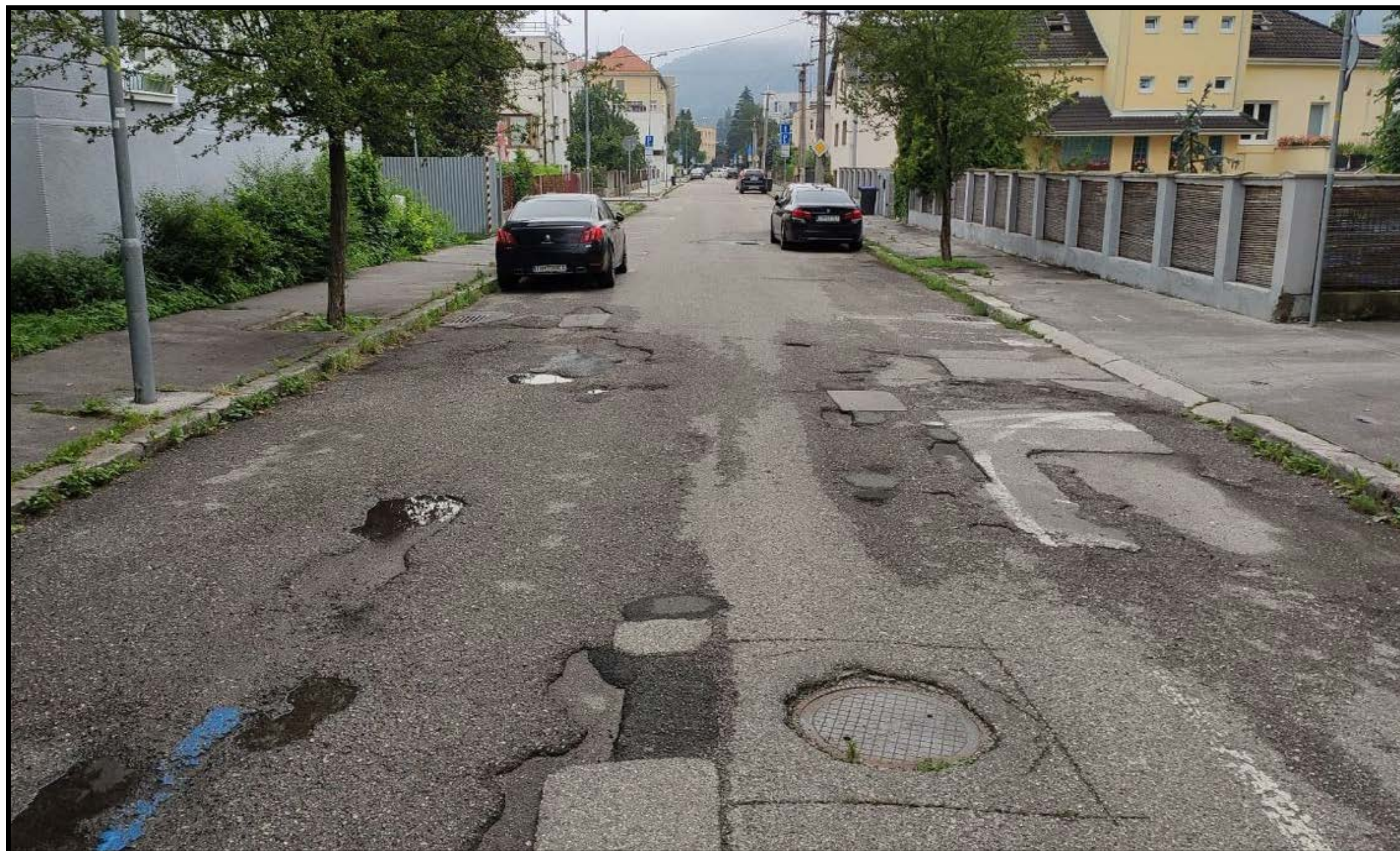
Rozbitá cesta - větší úsek
